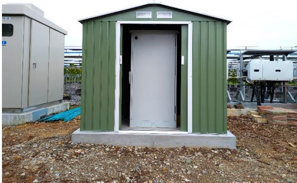
■今回設置した蓄電池（塩害対策の為、小屋に収まっています）
